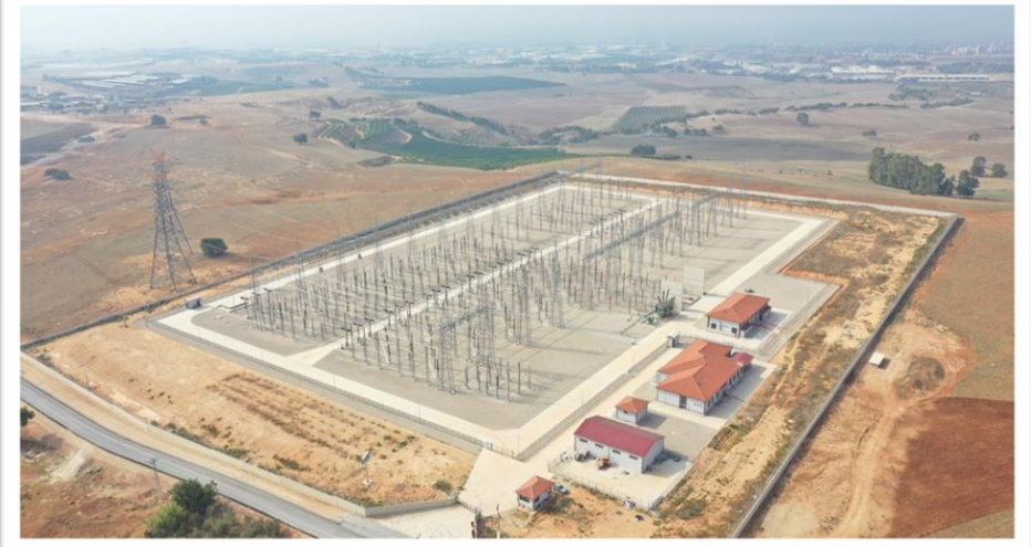
AOSB Trafo Merkezi Projesi
